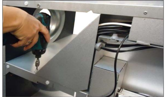
2. Poista kaapelisuoja(kuva2) Vedä cts 602 kortin hylly, sijaitsee lämmönvaihtimen yläpuolella.
